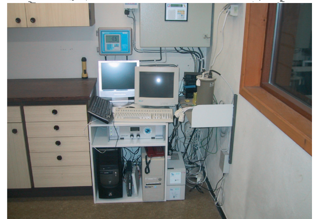
L'installation typique d'un capteur sismique
