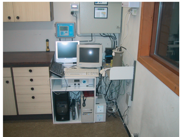
Typisk NNSN innendørs installasjon av en stasjon.
