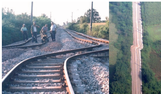
La figura muestra una ruptura de falla rumbo deslizante la cual desplaza la línea ferroviaria. La foto está relacionada con el terremoto de Izmit, Turquía, el 17 de agosto de 1999.
