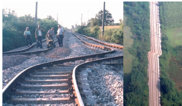
Das Bild zeigt eine Blattverschiebung. Das Ergebnis ist ein Versatz der Bahnschienen. Es wurde im Zusammenhang mit dem Beben in Izmit in der Türkei am 17. August 1999 aufgenommen.
